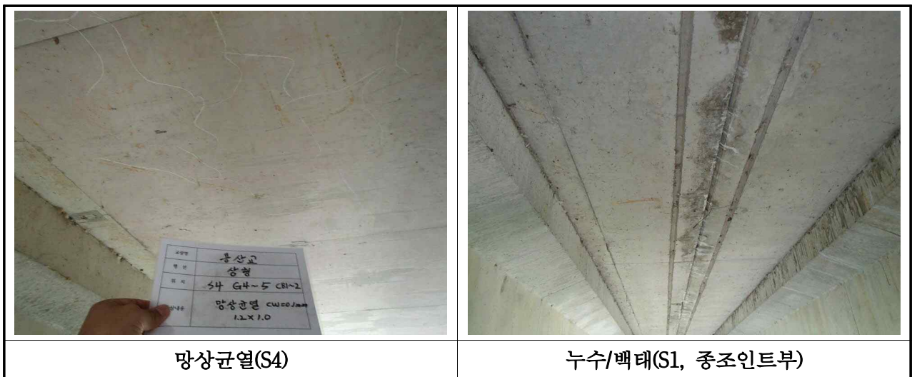
【사진 3.2.2】 바닥판 손상현황(대구)
