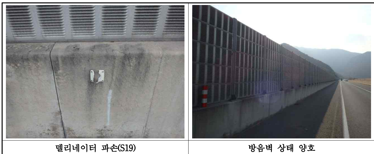
【사진 3.3.23】기타 시설 손상현황(부산)
