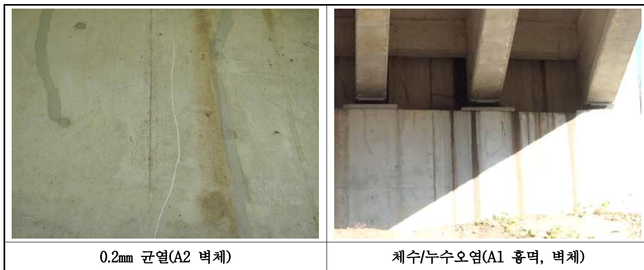
【사진 3.3.8】 교대 손상현황(부산)
