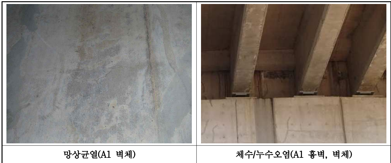
【사진 3.2.8】 교대 손상현황(대구)
