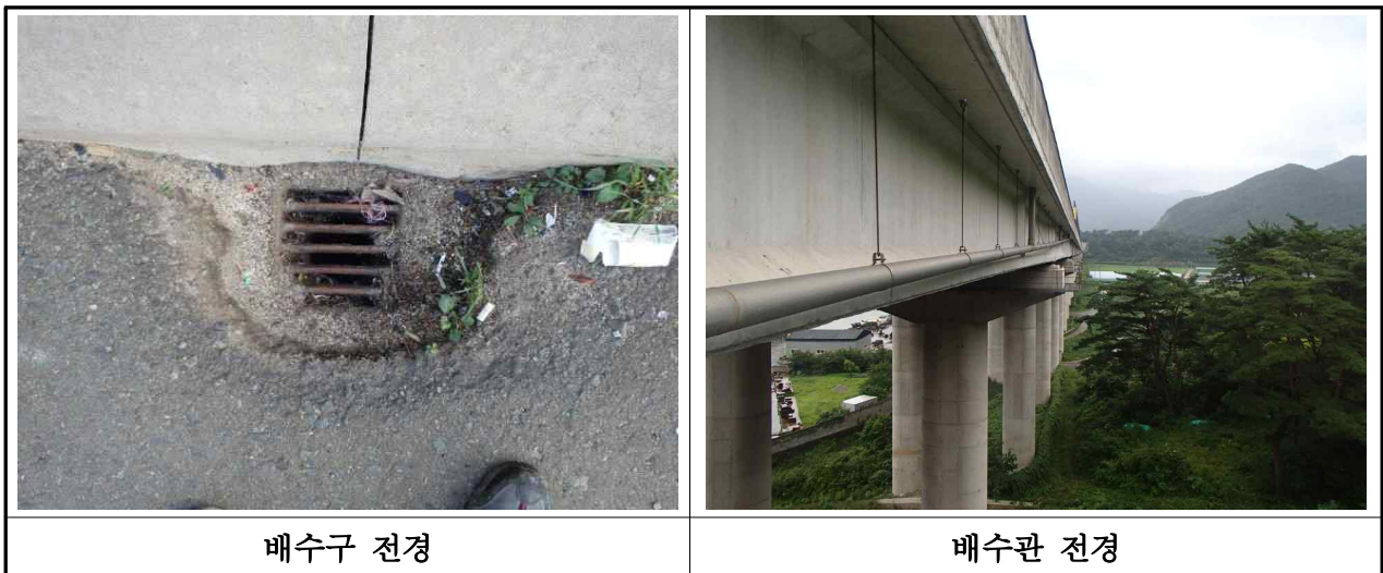
【사진 3.3.19】 배수구 및 배수관 전경(부산)
