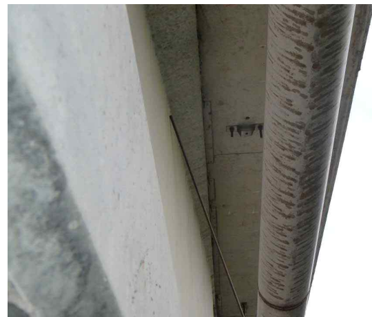
배수관 연결고리 탈락(S3)
