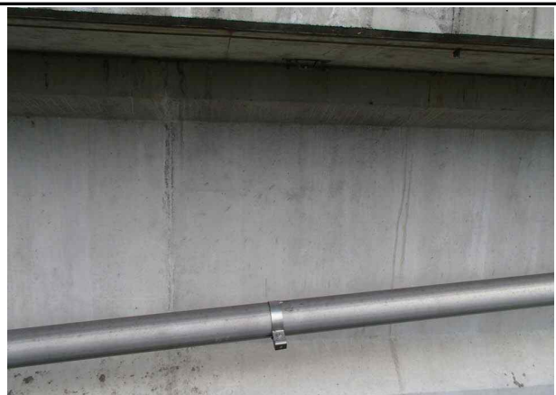
배수관 연결재(행거) 탈락(S4)
