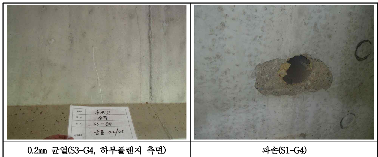
【사진 3.2.4】 PSC Beam 손상현황(대구)
