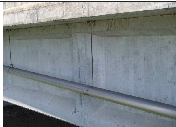
배수관 연결고리 탈락(S1)
