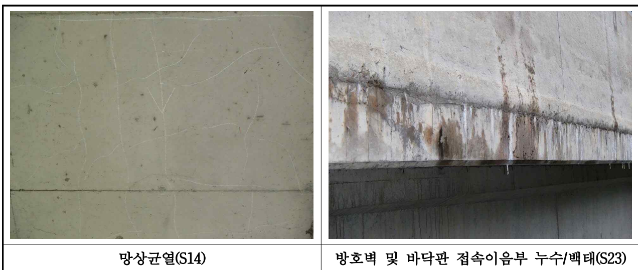
【사진 3.3.2】 바닥판 하면 손상현황(부산)
