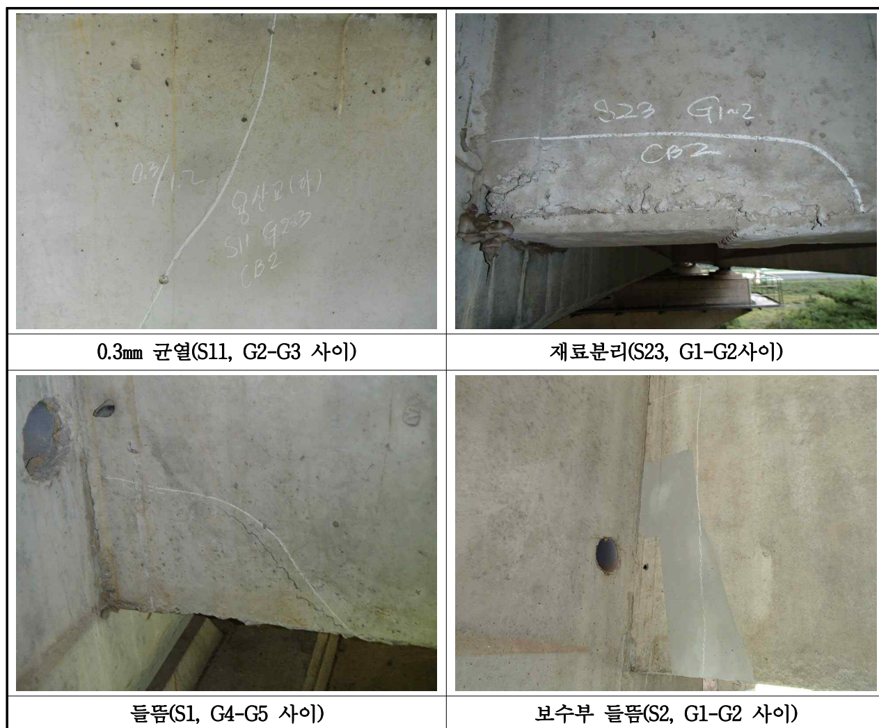
【사진 3.3.6】 가로보 손상현황(부산)
