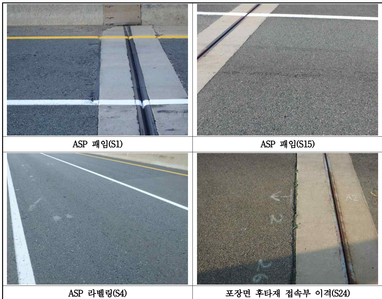
【사진 3.3.18】 교면포장 손상현황(부산)
