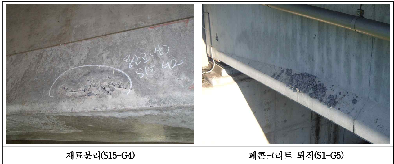
【사진 3.2.4】 PSC Beam 손상현황(대구, 계속)
