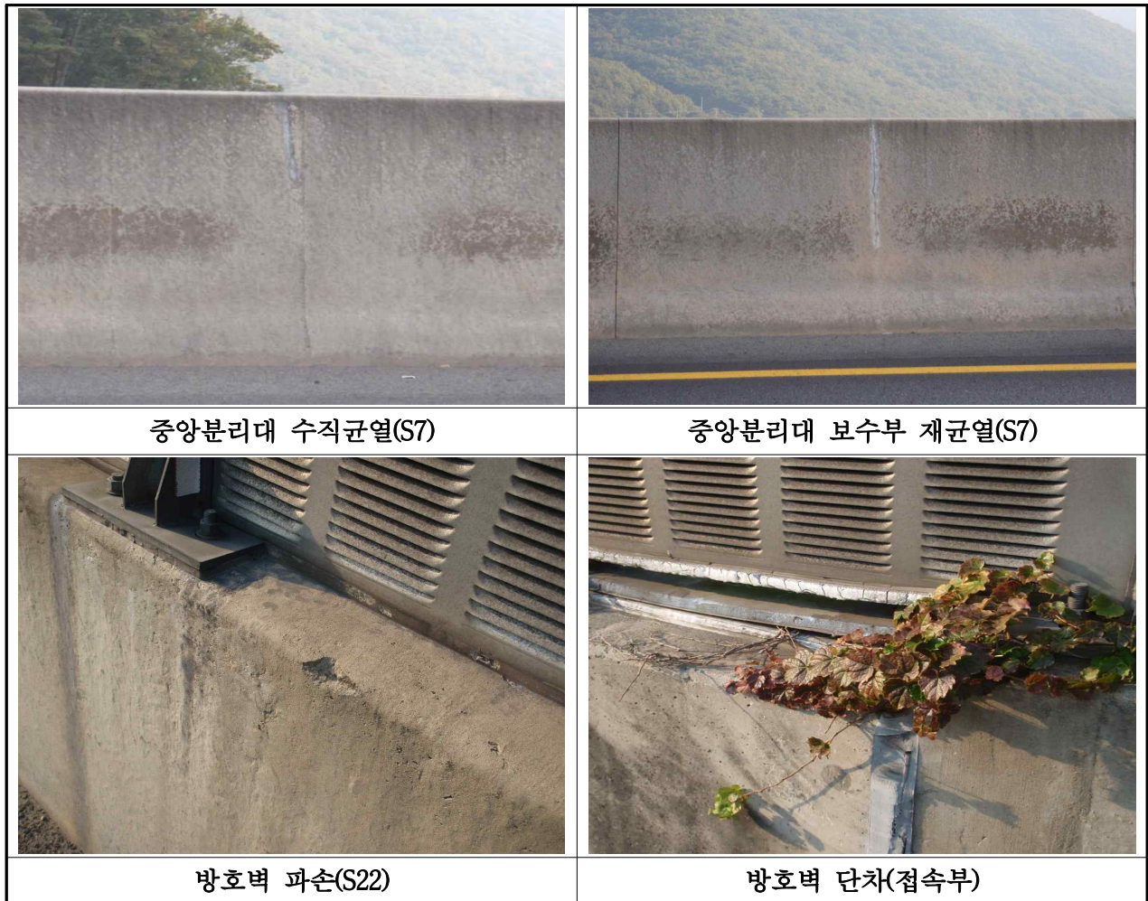
【사진 3.2.22】 방호벽 및 중앙분리대 손상현황(대구)
